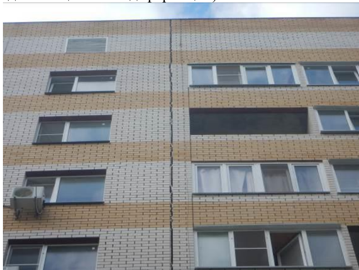
Рисунок 2. Трещина в стене шириной раскрытия до 35мм.
