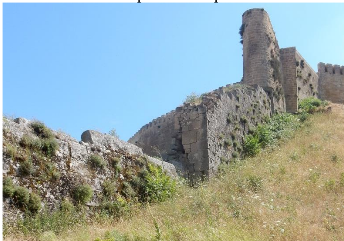
Рисунок 2. Разрушение стены крепости биологическим выветриванием (фото Е.И.Гончаровой, 23 июня 2022 г.)
