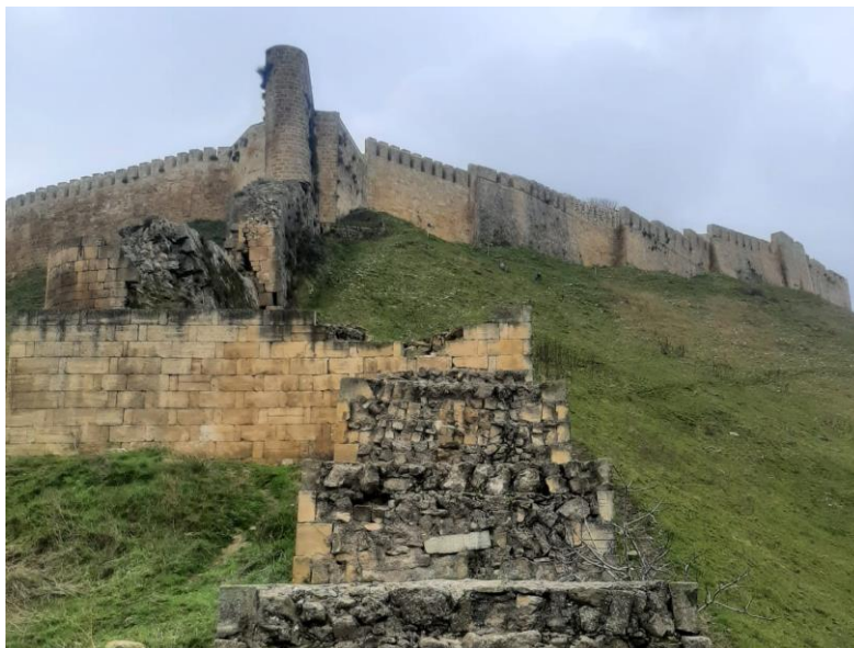
Рисунок 3. Разрушение стены крепости оползневыми процессами (фото Е.И.Гончаровой, 20 января 2022 г.)
