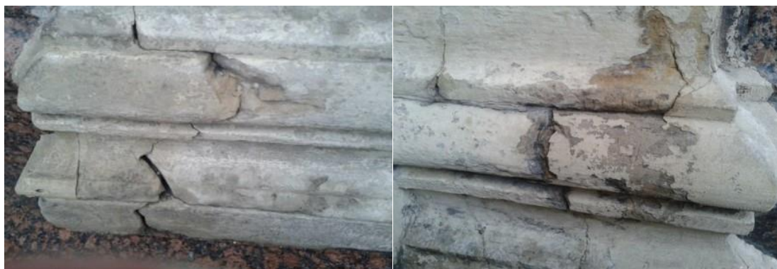
Рисунок 1. Трещины в несущих конструкциях Нового Эрмитажа со стороны Миллионной улицы (фото В.А. Горской)
