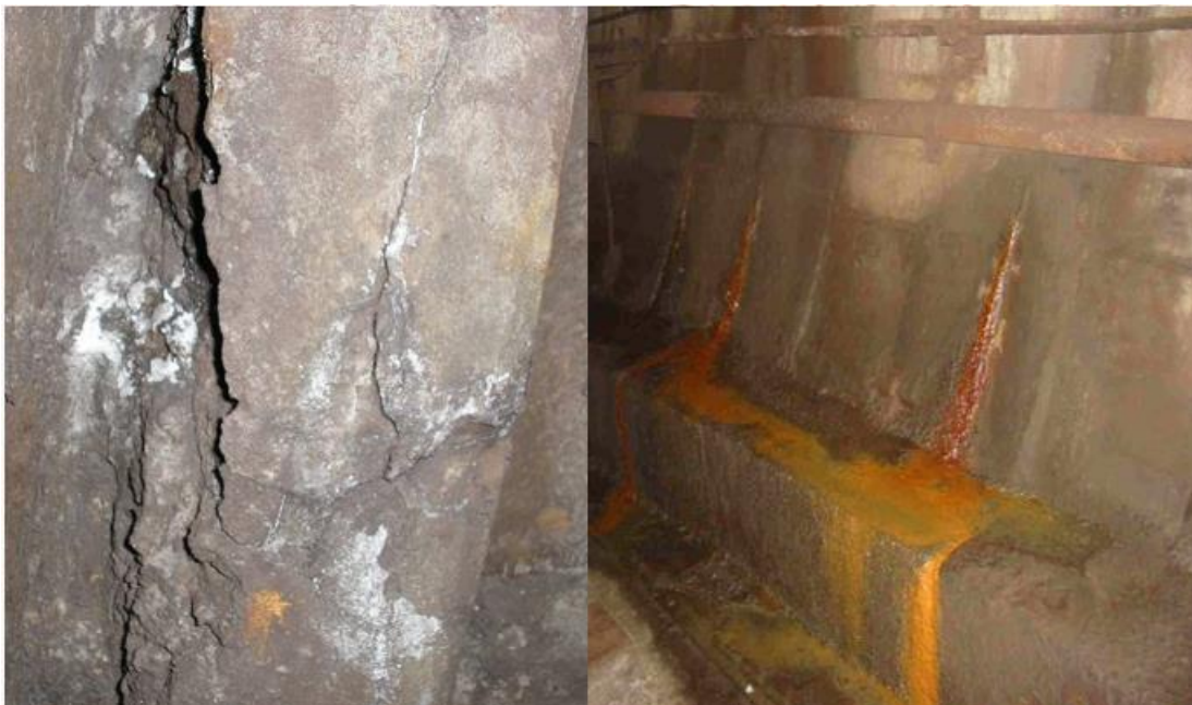
Рисунок 1. Активная коррозия и биокоррозия железобетонных трубков на больших глубинах (фото из архива проф. д. г.-м. н. Дашко Р.Э.).
